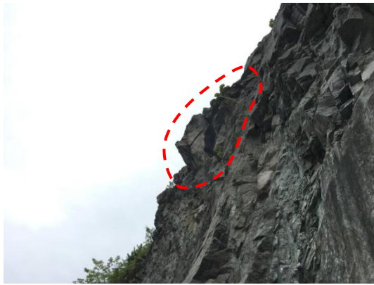
( 图 5: 易崩塌危岩 )
